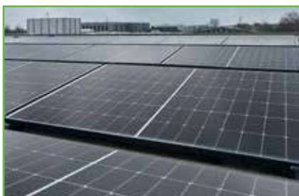
Neu-Ulm (DE) Start: 12.2023 Max. Leistung: 190 MWh
